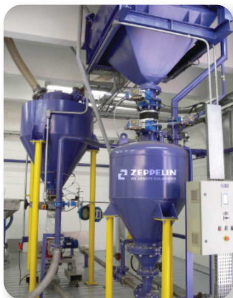
Centro de Testes. Test Center. Centro Tecnológico.
