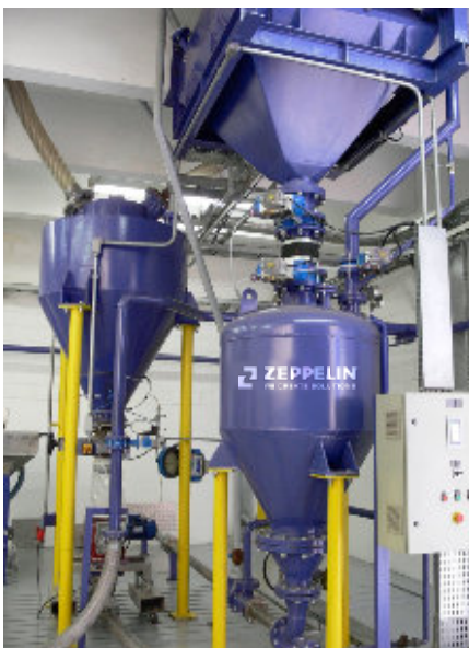
Centro de testes / Test Center Centro tecnológico
